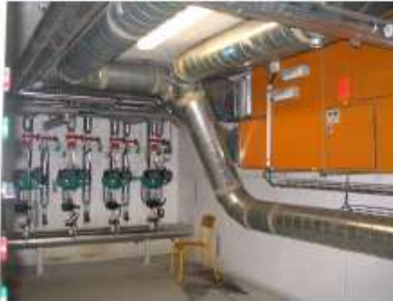
Sous station des bâtiments D et F
